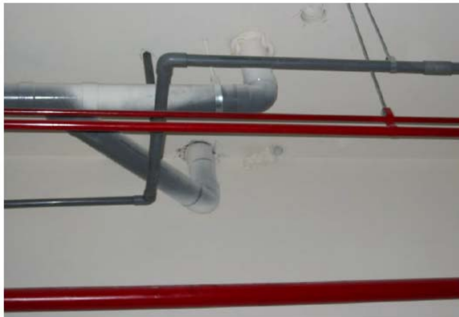
圖 1.12 污排水管路轉彎處未採 2 只 45 度彎頭銜接
