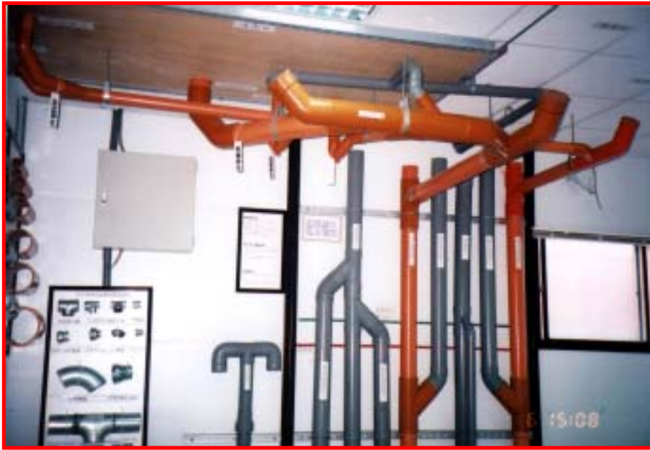
圖 1.3 污排水管與通氣管配管施工法展示樣品屋
