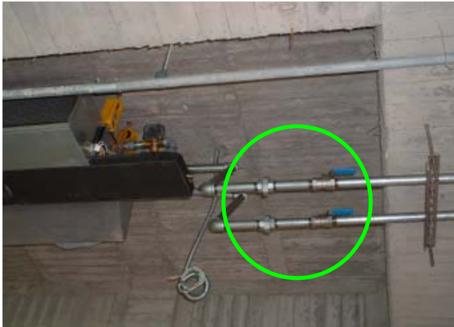
圖 1.25 冰水管進出口須裝置由令，以利維修時拆卸
