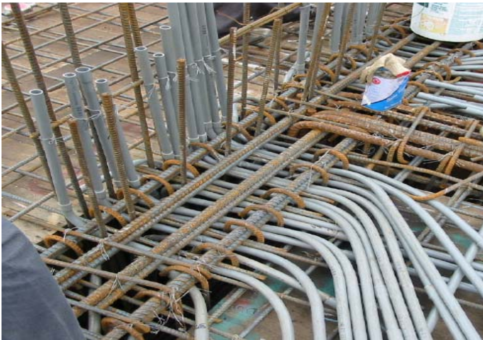
圖 1.20 電氣管路配設交叉重疊過高且過度密集
