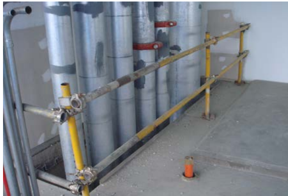
不恰當之管道間留設方式，無法完整施作防火填塞
