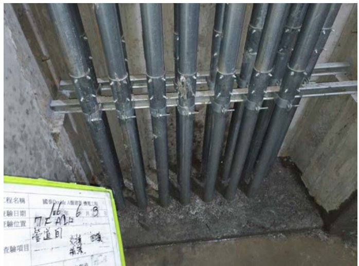
機水電管線貫穿樓版部份採預留套管方便填封阻火材料施工示意例
