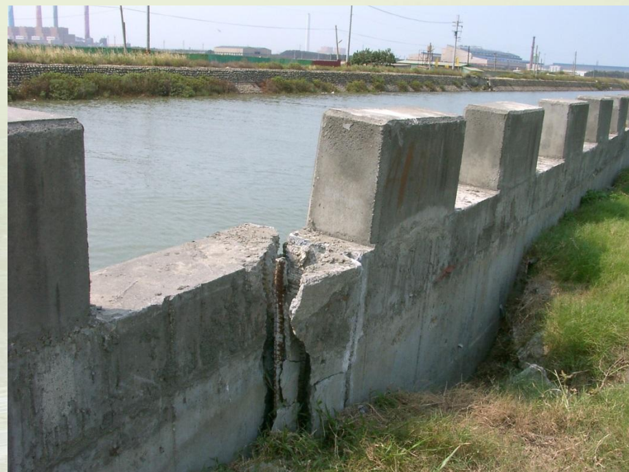
河岸設施因被動不足而位移
