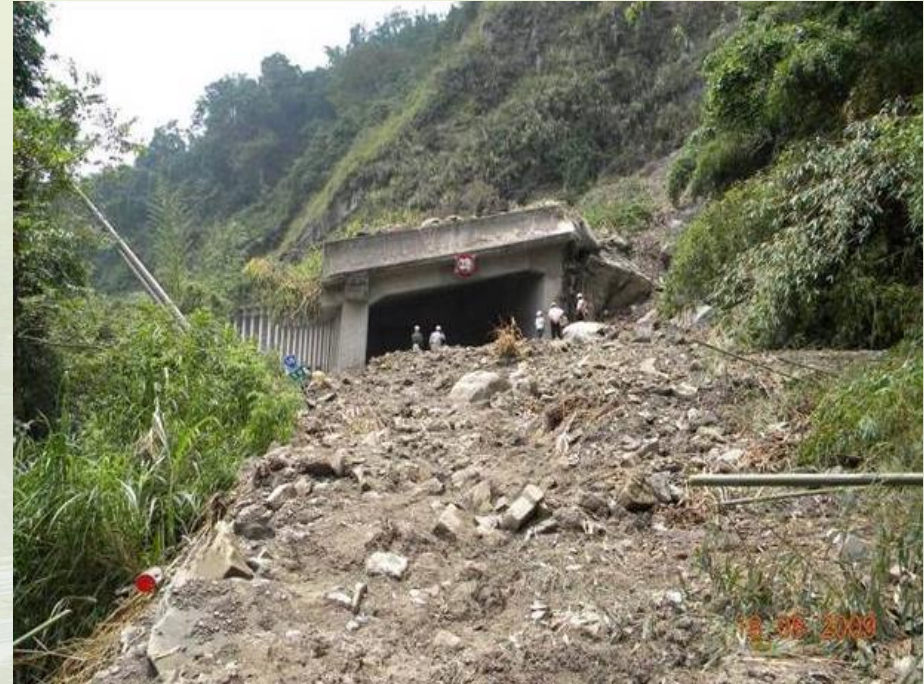
明隧道長度不足洞口遭土石掩埋
