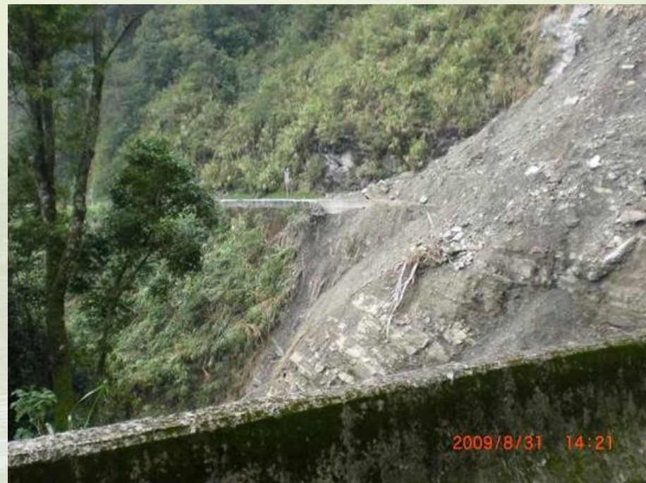
邊坡滑動道路路基流失
