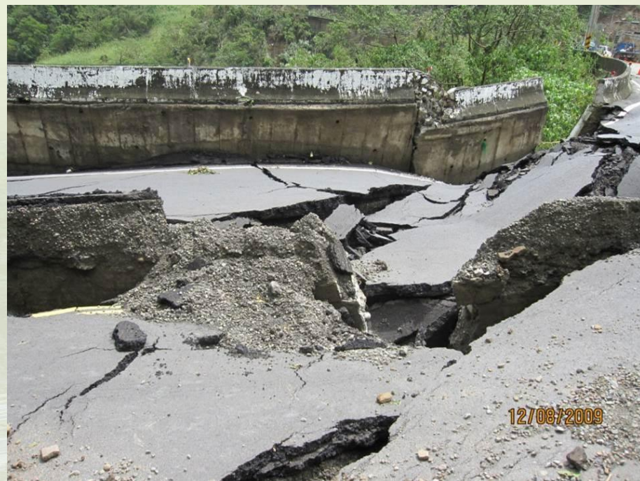
道路位於滑動區而破壞
