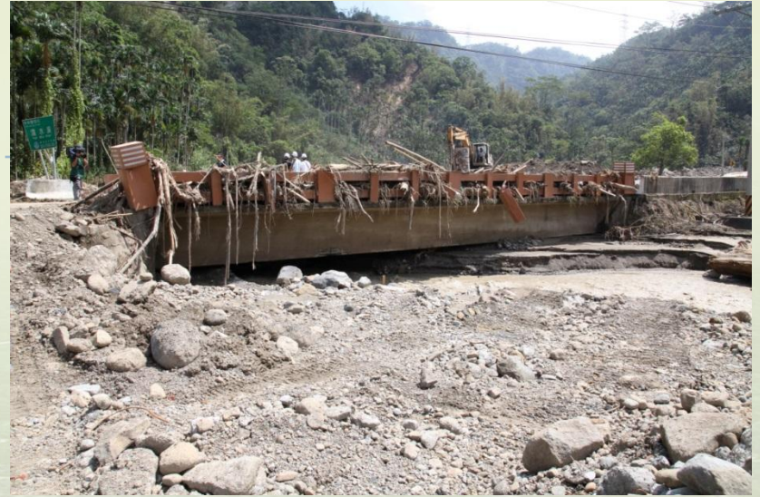
橋梁跨度與淨高不足
