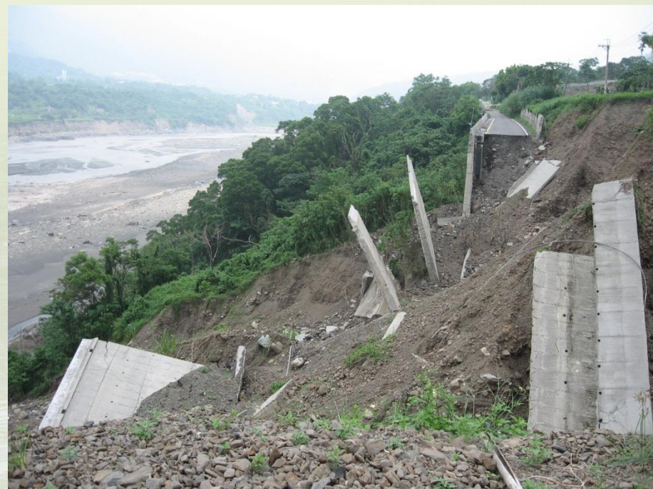
擋土牆因邊坡坡趾掏刷而破壞
