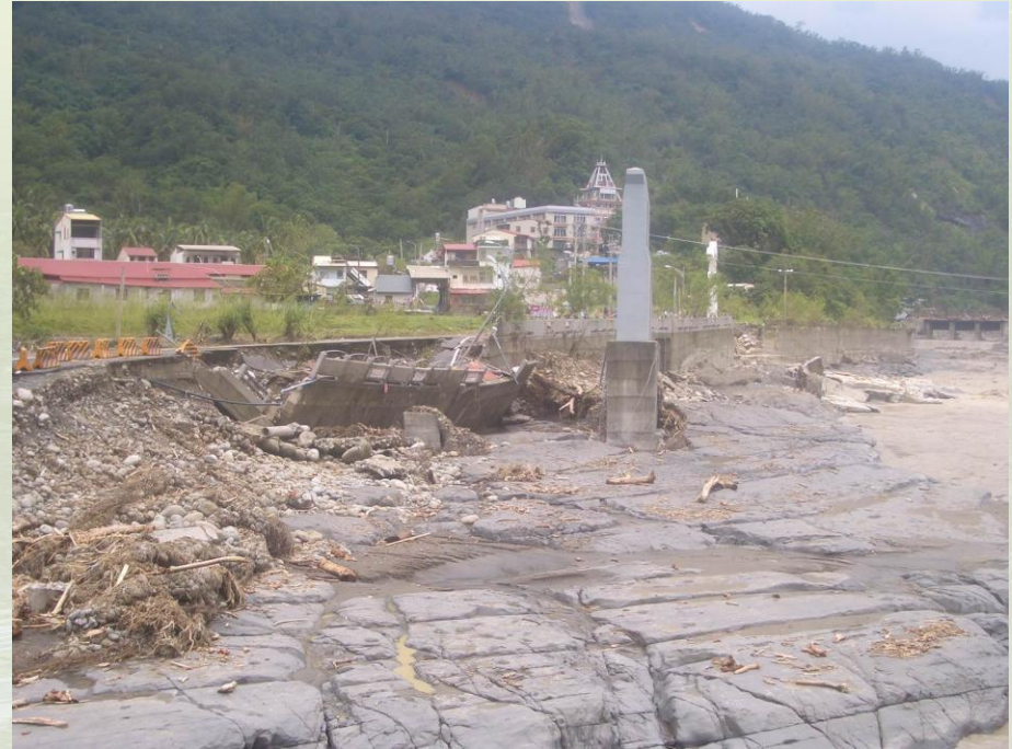
護岸基礎掏刷而破壞
