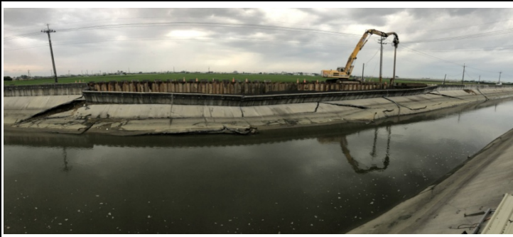
坡面工崩塌損壞情形
