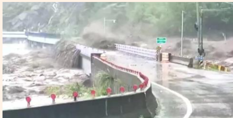
橋梁洪患斷裂
