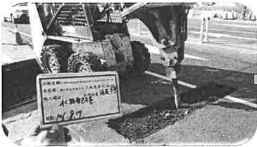
改善中：寬頻管線下陷
