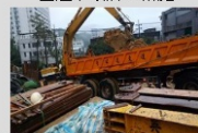
附件六-2承商雨天回填部分屬暫置作業，已請承商挖除 審查通過 基隆市政府工務處
