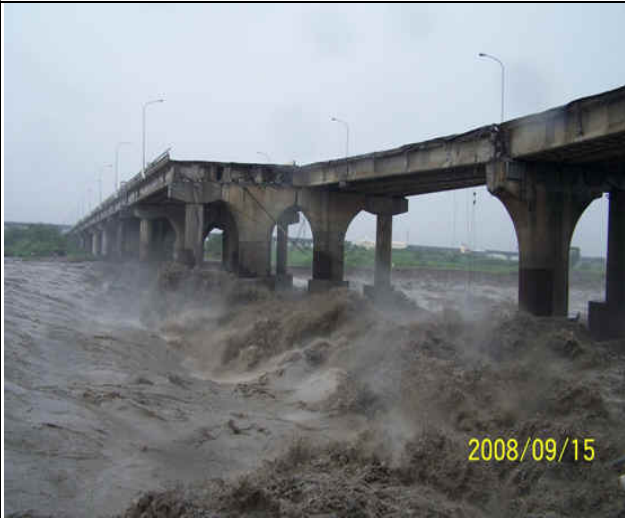
說明：后豐大橋斷橋橋墩處
