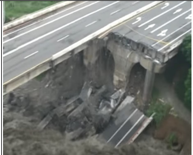
說明：后豐大橋斷橋處空拍照
