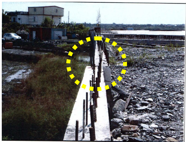
圖 2. 擋土牆體出現相對位移
