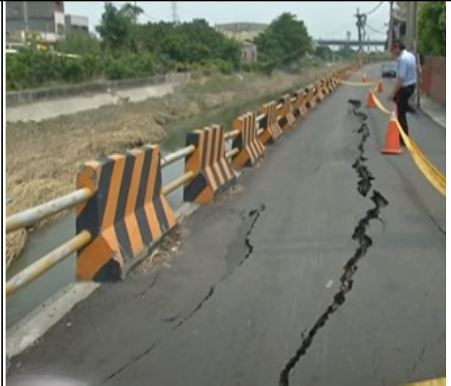
說明：護岸道路坍塌情形
