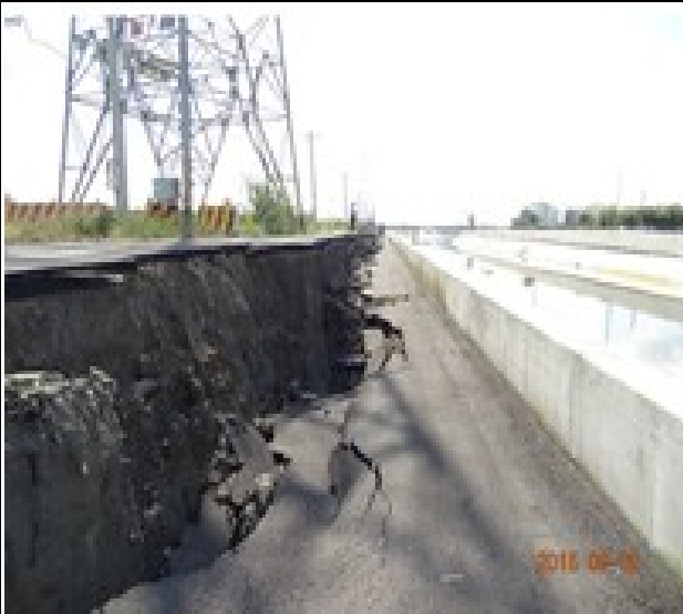
說明：堤內側坍塌情形
