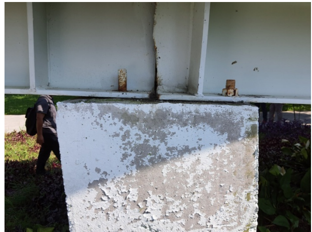
圖 4. 帽梁座施工缺失
