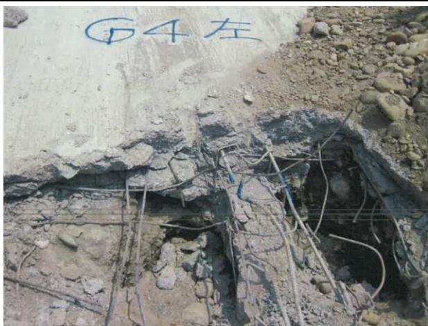
丁壩格樑部分鋼筋保護層不足
