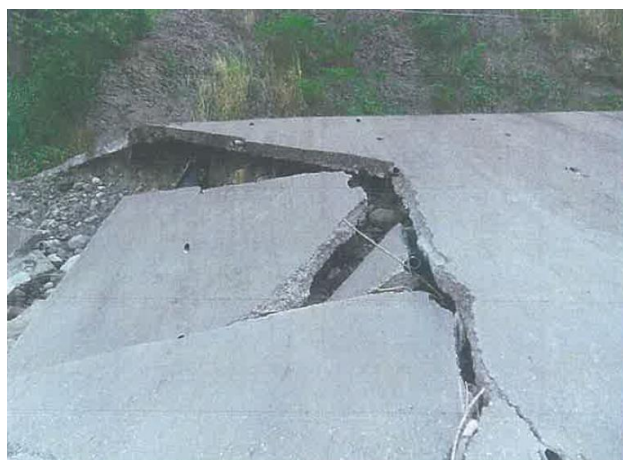
坡面工厚度不足，致坡面因颱風豪雨破損
