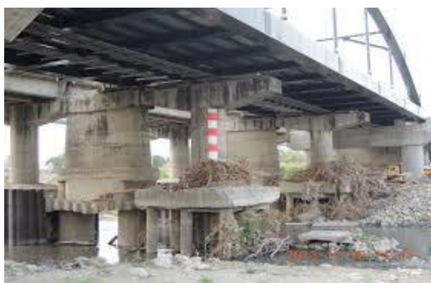
平和橋橋墩基礎沖刷裸露情形
