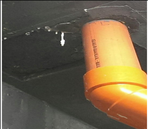
說明：天花板漏水(國立宜蘭大學提供)
