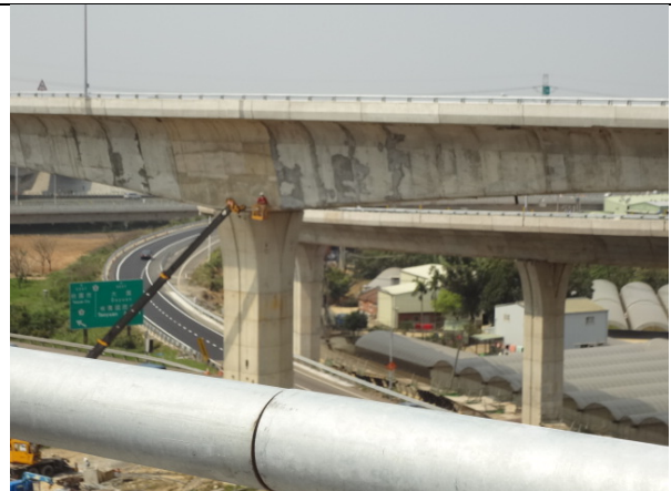
箱梁混凝土施工瑕疵照片
