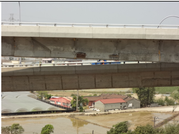
箱梁混凝土施工瑕疵照片
