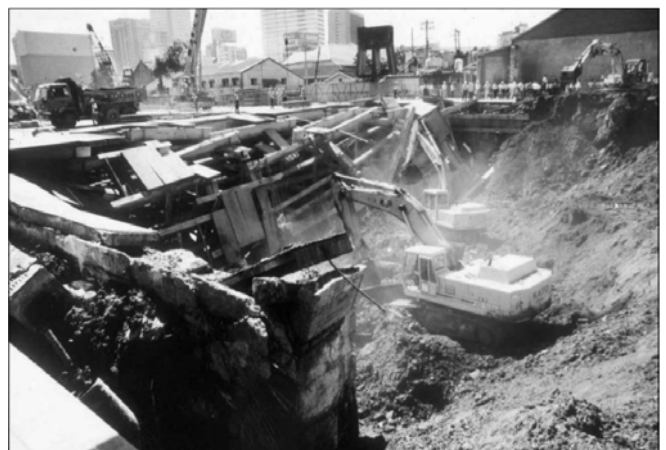
台北市鄭州路地下街災變照片
