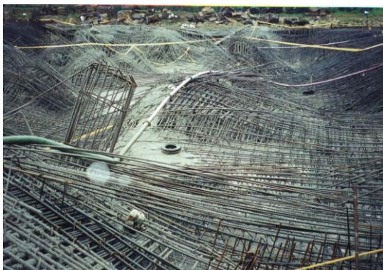
模板支撐發生倒塌
