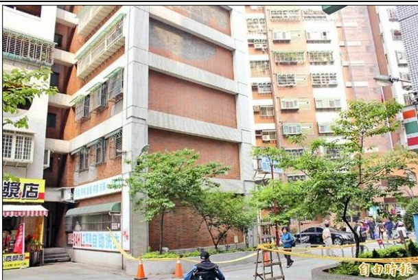
桃園市八德區陸光四村國宅社區外牆磁磚剝落嚴重。(記者林子翔攝)
