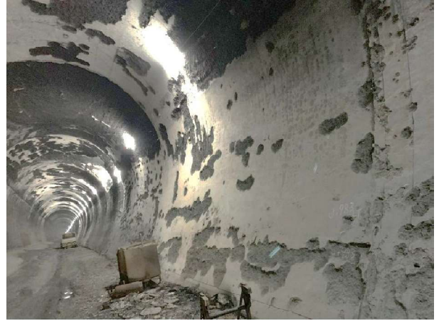
防淤隧道災後調查照片
