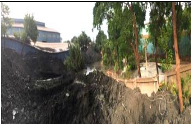
中油廠區側災損情形
