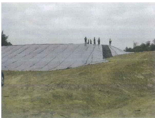
滯洪沉砂池下邊坡高差超過 10m，已違反水土保持技術規範第 154 條規定，恐影響臨近道路及民宅安全
