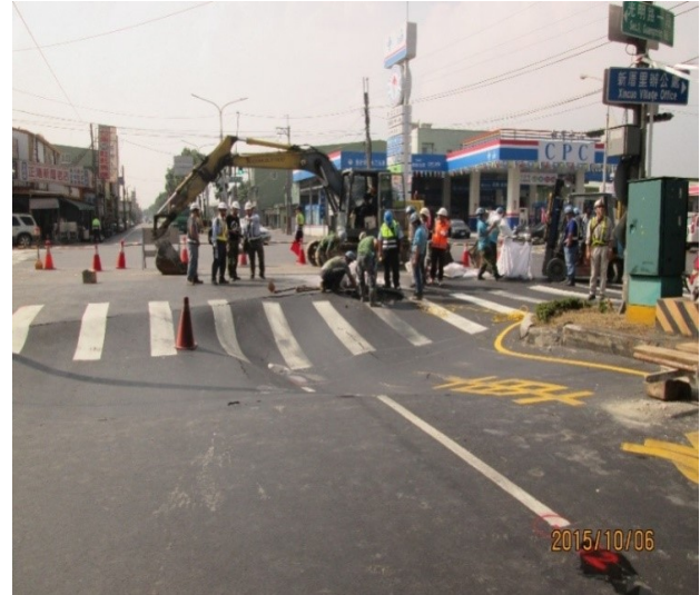
104 年 10 月 6 日上午路面塌陷及準備試挖情形
