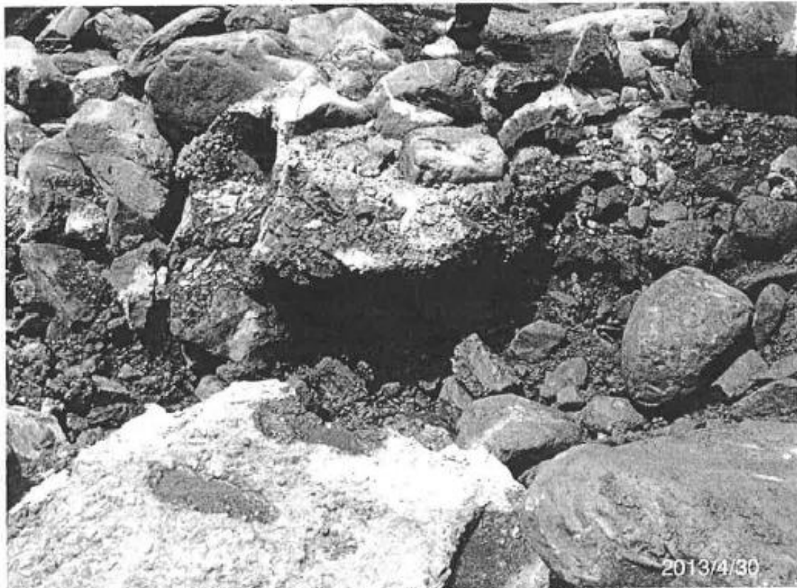
第 16 號固床工開挖後深度明顯不足，設計深度 1.5m，實際施作深度僅 80cm，且內部不應以大石塊堆置，另由開挖情況顯示施作時並未使用模板。
