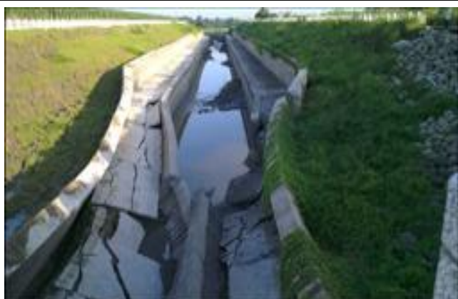
(疏洪道坍塌情形，取自審計部 106 年 10 月專案審計報告)
