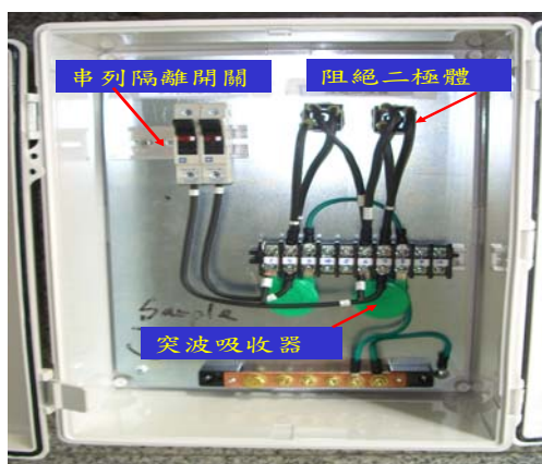
圖 11、直流接線箱內部配置
